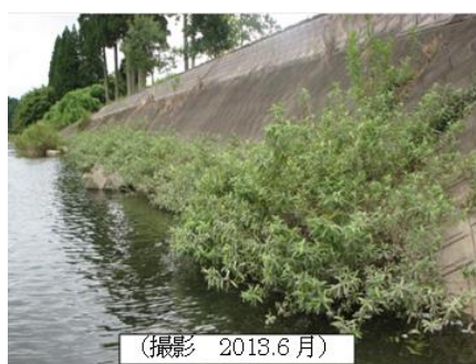
調査時点の繁茂状況
