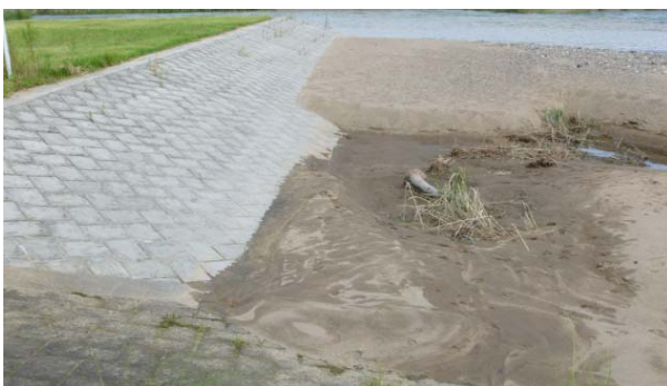
出水後の流砂堆積の状況
