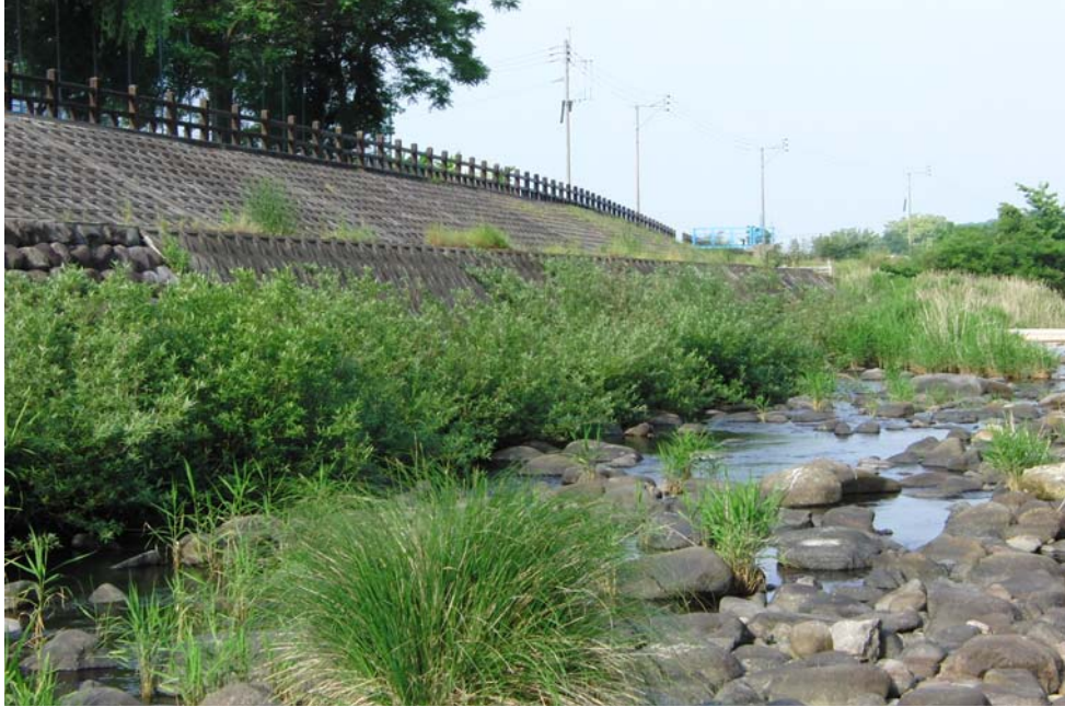
写真一No.5の2 ブロック積護岸における繁茂状況 2009.3 施工（3年経過）撮影日：2012.05.30（福岡県豊前土木事務所）
