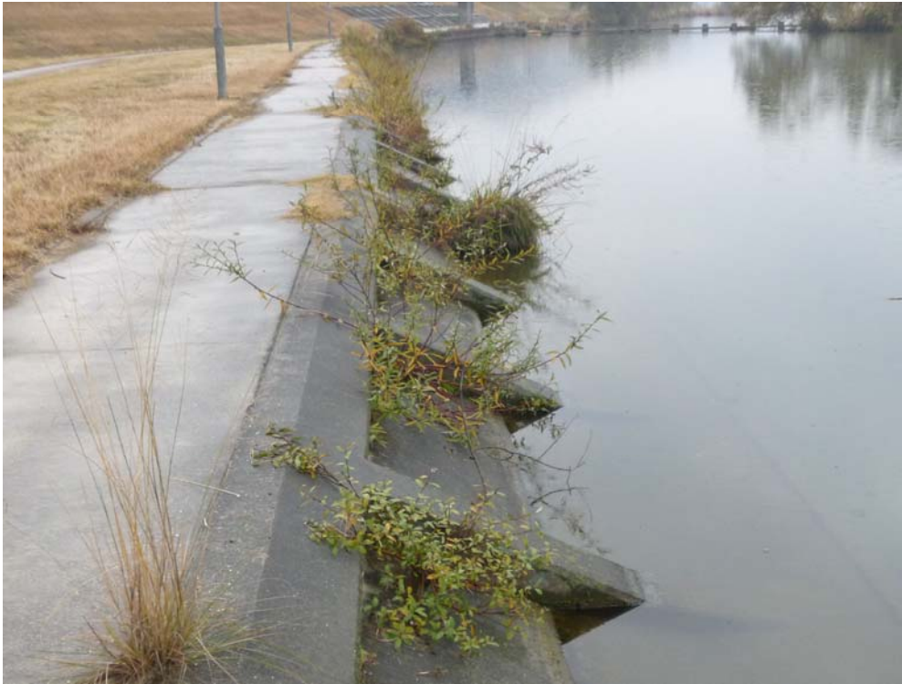
写真一No.27 芦田川 河口堰上流右岸側の成長状況 2012.3 施工（1年経過）撮影日：2013.11.27（国土交通省福山河川国道事務所）
