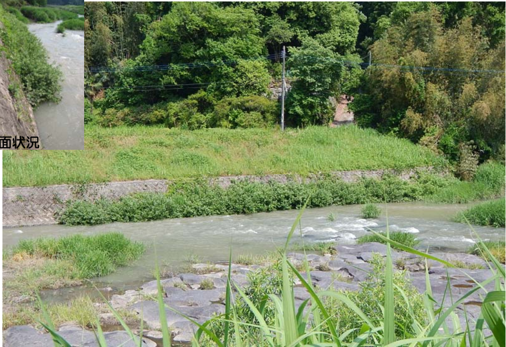
写真一No.9の1 大野川水系平井川 右岸護岸上流部の繁茂状況 2010.3 施工（4年経過） 撮影日：2014.05.21（大分県豊後大野土木事務所）
