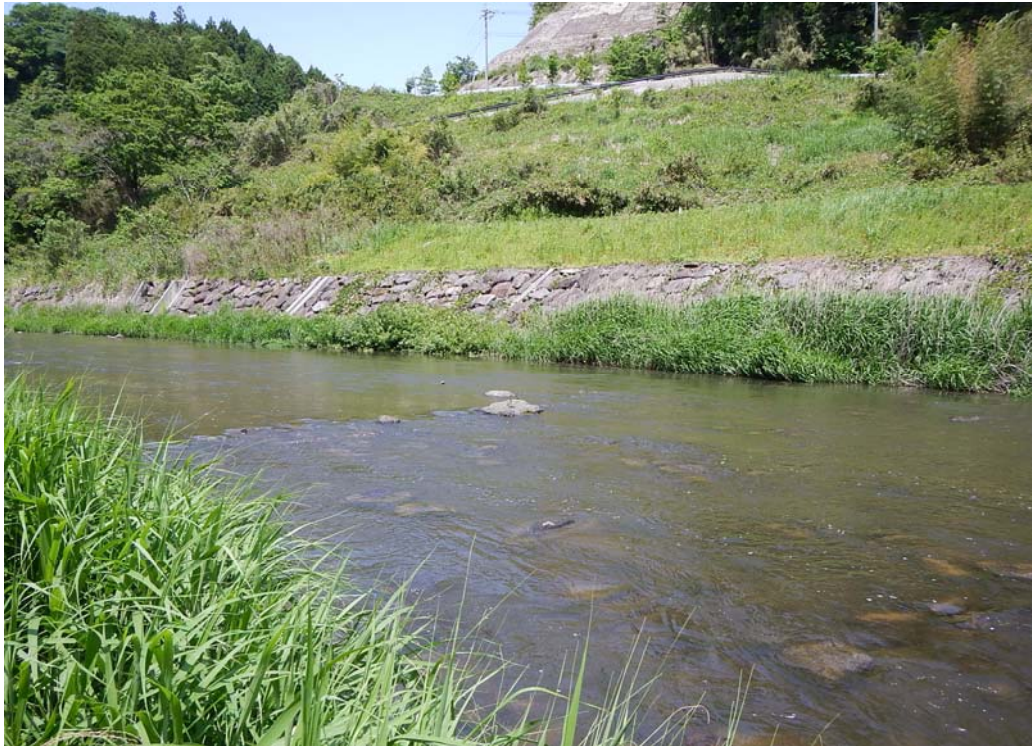
写真一No.10 大野川水系稲葉川 ダム下流左岸側の巨石護岸の繁茂状況 2010.3 施工（4年経過）撮影日：2014.05.21（大分県竹田ダム事務所）
