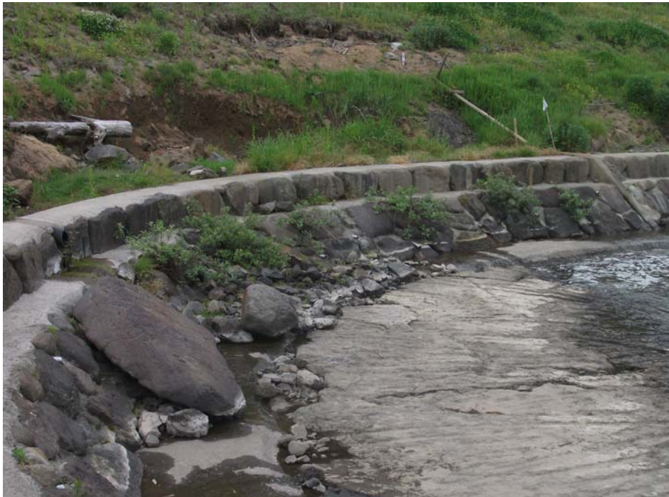
写真一No.19 の 1 稲葉川ダム上流右岸側の繁茂状況 2011.3 施工（2年経過）撮影日：2013.05.16（大分県竹田ダム事務所） 注）この場所は、その後の洪水流により被災して流失したため、再植栽を検討中。
