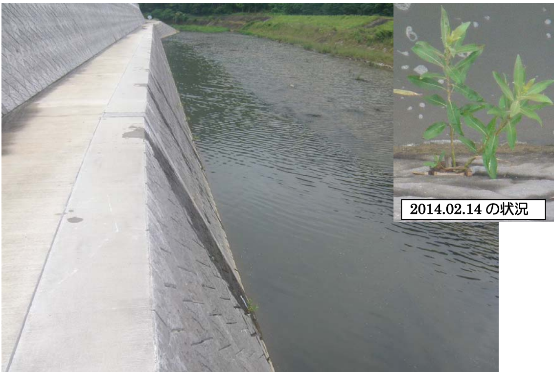
写真一No.33 の1 松浦川水系徳須恵川 行合野地区左岸の植栽場所と再植栽直後 2013.3 施工（1 年経過） 撮影日：2014.02.14（国土交通省武雄河川事務所） 注）背面水の不足と出水の損傷などにより枯死したため、2014 年 3 月再植栽を行った。現在、経過観察中。
