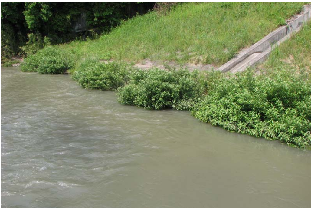
写真一No.9の2 右岸下流部の玉石護岸の繁茂状況 2010.3 施工（4年経過） 撮影日：2014.05.21（大分県豊後大野土木事務所）
