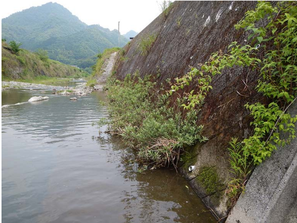
写真一No.4の2 既設護岸に対する植栽繁茂状況 2009.3 施工（5年経過）撮影日：2014.06.09（大分県中津土木事務所）
