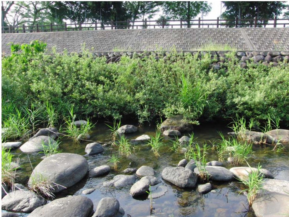
写真一No.5の1 二級河川岩岳川 玉石積護岸における繁茂状況 2009.3 施工（3年経過）撮影日：2012.05.30（福岡県豊前土木事務所）
