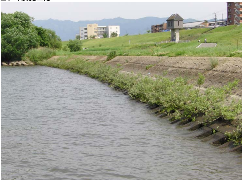
写真-No.3 筑後川 くるめウス公園周辺護岸の繁茂状況
