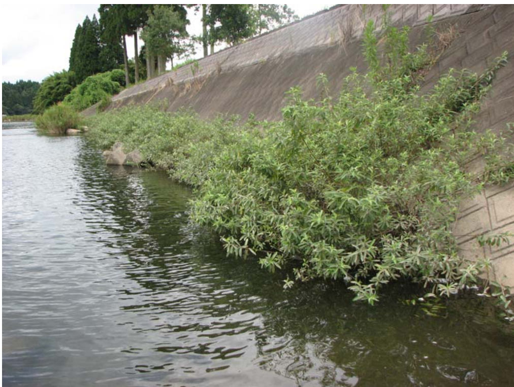
写真一No.6 の1 川内川 鶴田地区右岸側護岸の繁茂状況 2010.3 施工（3 年経過）撮影日：2013.07.22（国土交通省川内川河川事務所）
