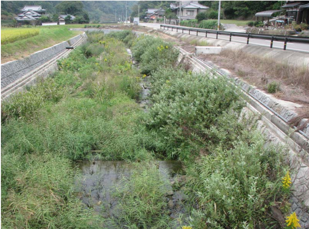
写真一No.17 の1 二級河川真玉川 右岸側護岸（ポーラス）の繁茂状況 2010.3 施工（3年経過）撮影日：2013.12.07（大分県豊後高田土木事務所）
